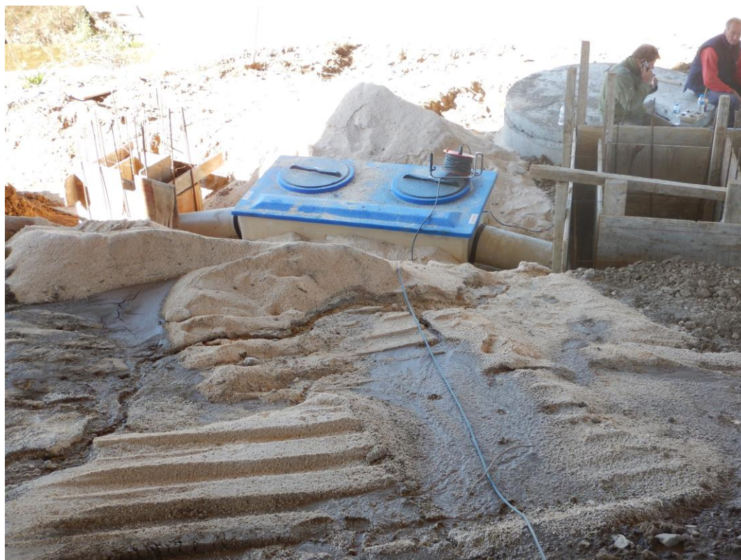
Γέφυρα π. Πηνειού (ανάντη). Μονάδα διαχωριστή τύπου SAINT DIZIER και δεξαμενή αποθήκευσης.
