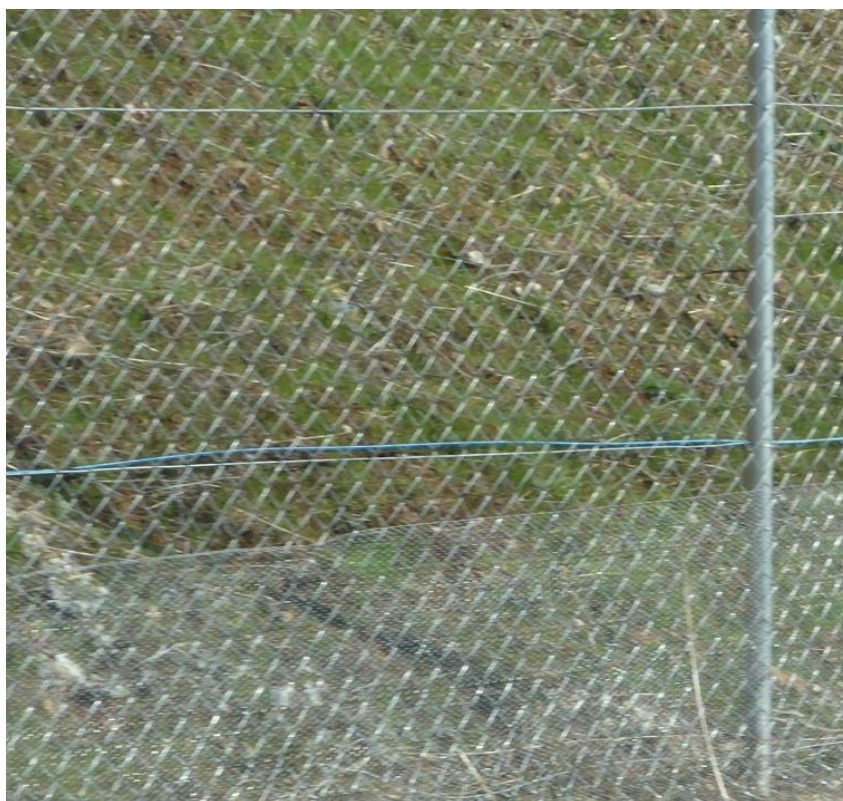
Διπλή περίφραξη διαφορετικής οπής πλέγματος για την αποτροπή εισόδου μικρόσωμων θηλαστικών εντός του αυτ/μου.
