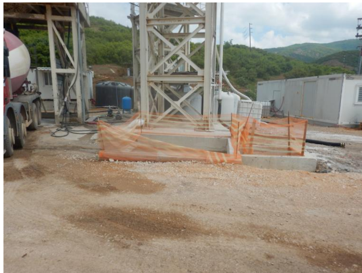
Δίχωση δεξαμενή καθίζησης αποβλήτων παρασκευαστηρίου σκυροδέματος στο εργοτάξιο «Σαμόλακας»
