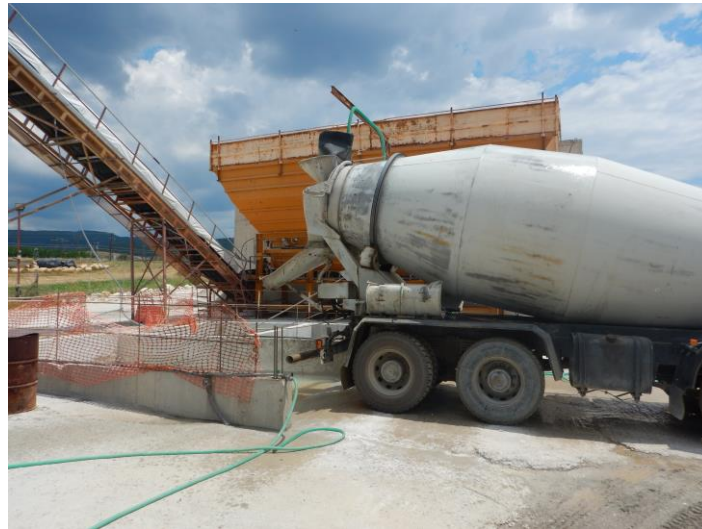
Τρίχωρη δεξαμενή καθίζησης αποβλήτων παρασκευαστηρίου σκυροδέματος στο εργοτάξιο «Λυγαριάς» (Χ.Θ. 19+700) και ξέπλυμα βαρέλας εντός αυτής.
