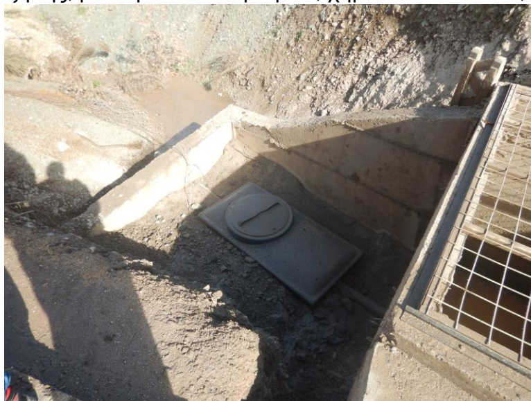
Ελαιοδιαχωριστήρας στο συνεργείο του εργοταξίου «Φτέρες»
