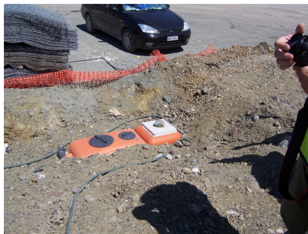
Εγκατάσταση compact βιολογικού καθαρισμού για την επεξεργασία των λυμάτων αστικής φύσης.
