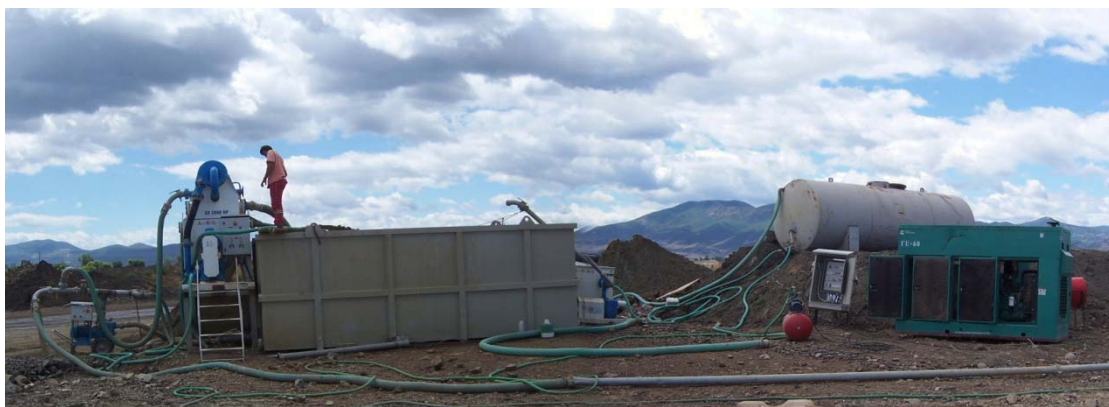
Λειτουργία κλειστού και στεγανού συστήματος παρασκευής μπετονίτη.
