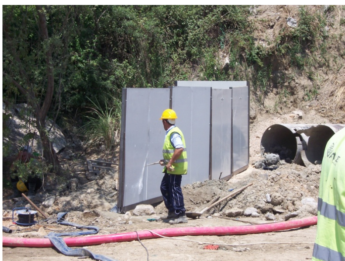
Τοποθέτηση κινητών ηχοπετασμάτων στην περιοχή κατασκευής της γέφυρας του π. Σπερχειού (νέα κοίτη – Χ.Θ. 4+560 περίπου)
